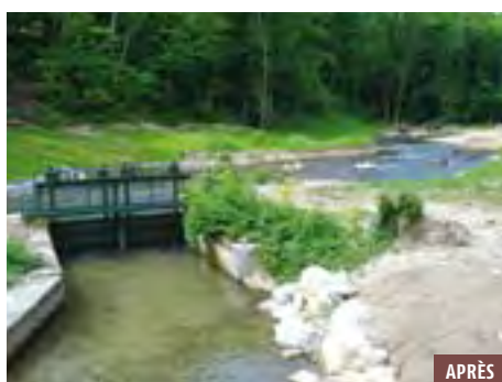
Nouvelle prise d'eau du canal de la Papeterie.
